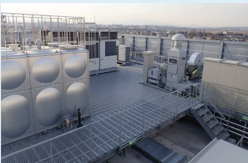
【屋上設備機械置場】
