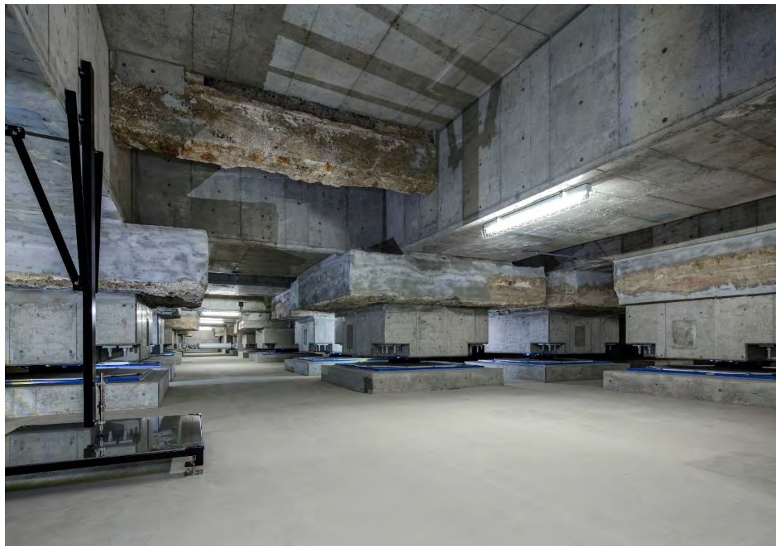
免震層（基礎下免震）
