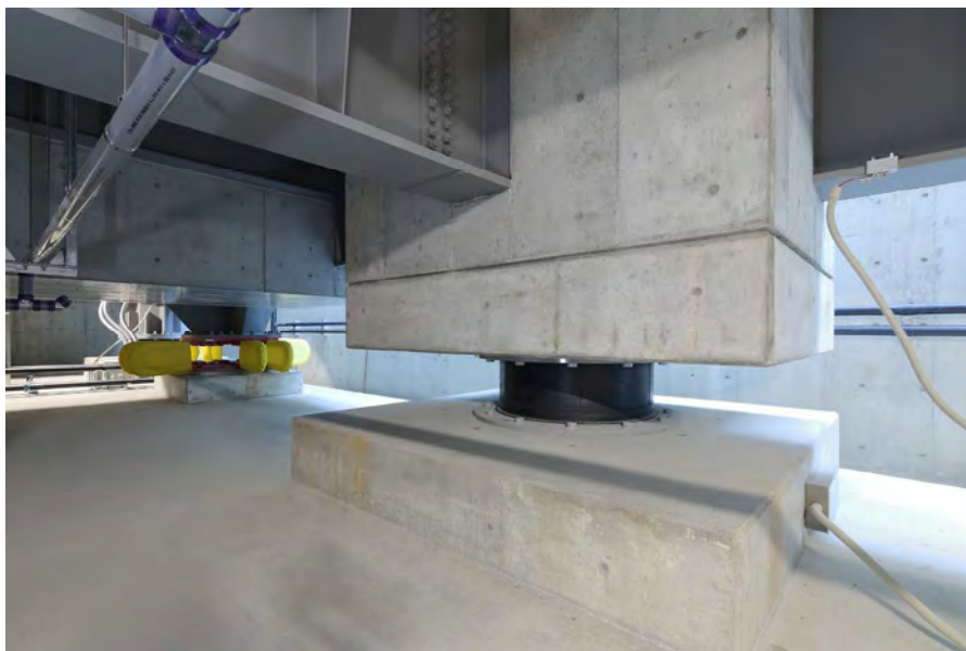
免震装置（積層ゴム支承）
